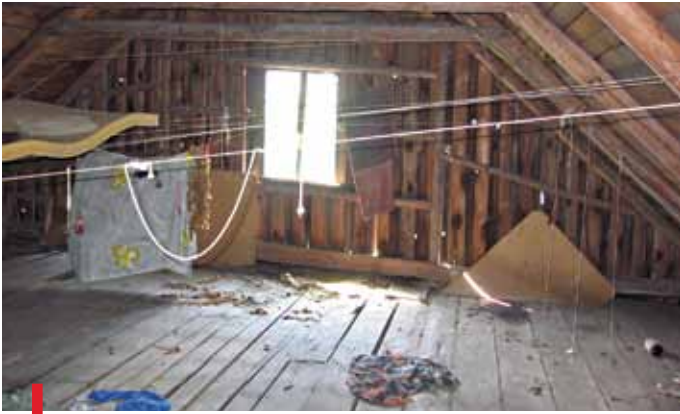
Stuletni dom wymagał natychmiastowego remontu. Trawiły go grzyby i korniki, po ziemi popękała instalacja wodna, kominem lała się do wnętrza woda. Dom przez całe lata był nieogrzewany. Nikt w 2006 r. nie dałby więcej za to siedlisko
